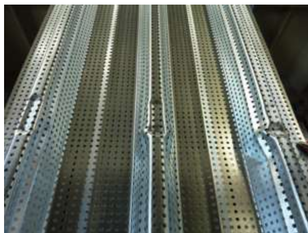
Figure 1.3.12 – Plaque nervurée perforée totalement après essai d'appui intérieur
